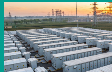
ii) Unidades de armazenamento
